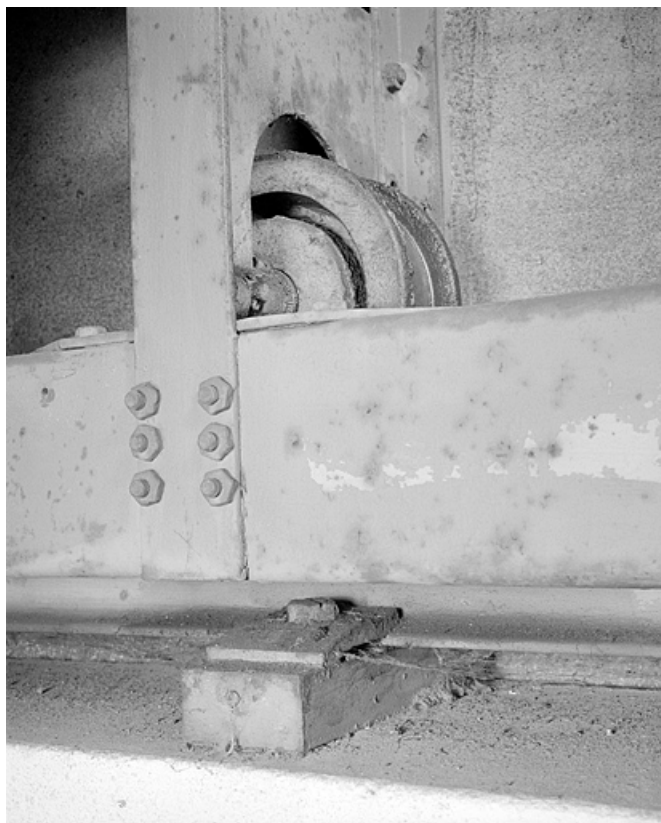
Détail du système de rotation de la coupole : galet.
