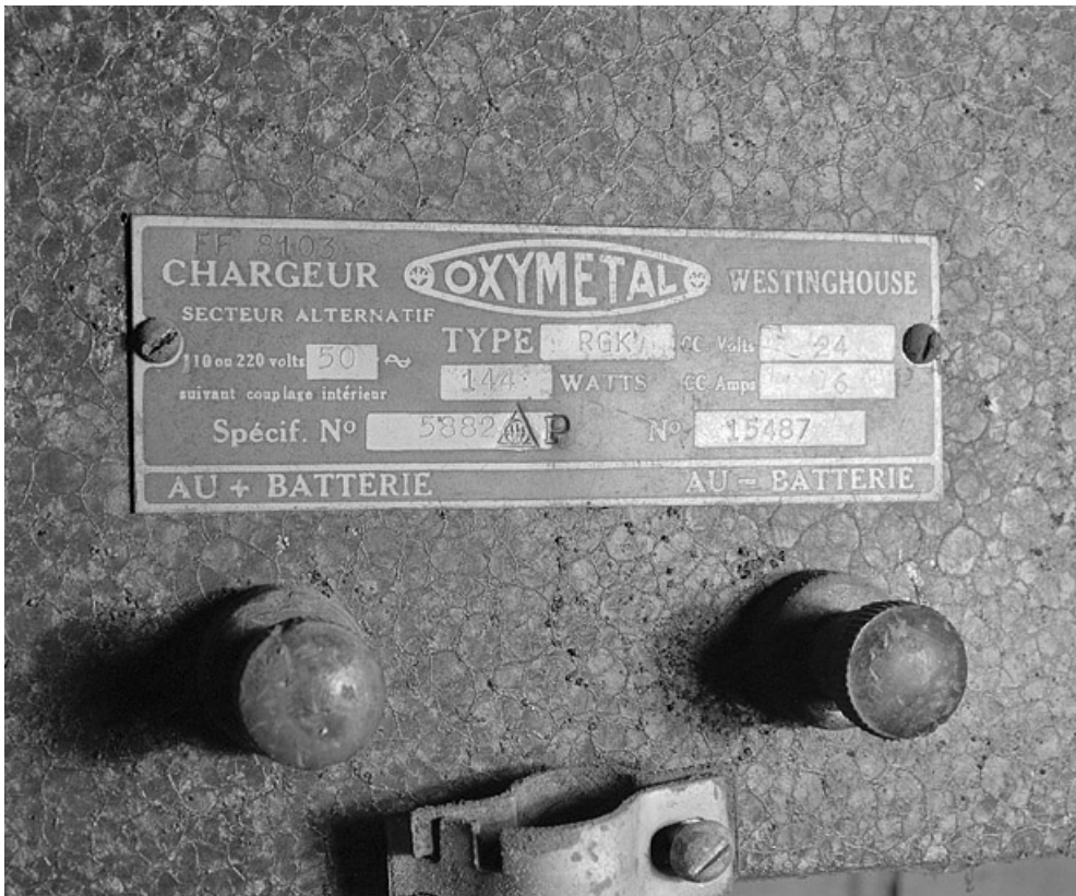
Chargeur de batterie Oxymétal Westinghouse : plaque signalétique.
