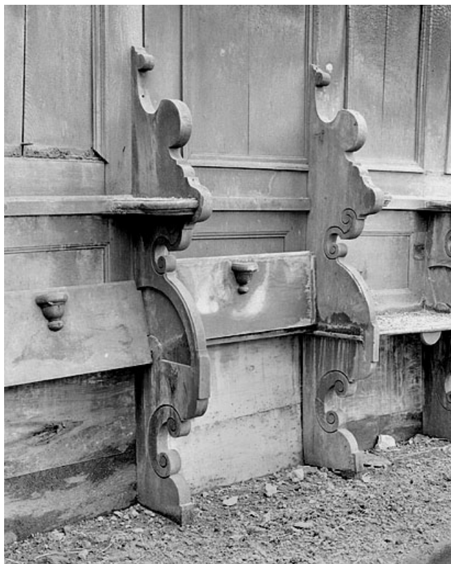
Détail d'une stalle du mur sud du chœur après l'incendie de 1987. 25, Montbéliard place Saint-Georges
