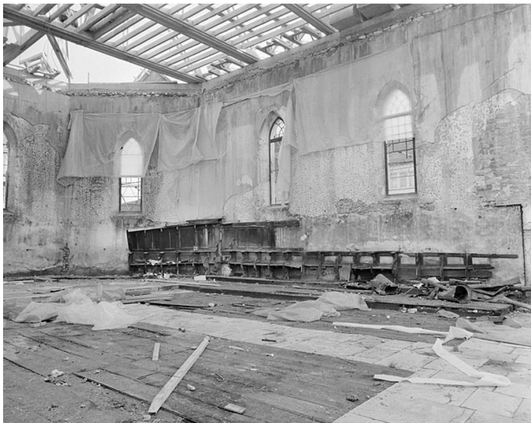
Vue d'ensemble des éléments subsistants des stalles après l'incendie de 1987. 25, Montbéliard place Saint-Georges
