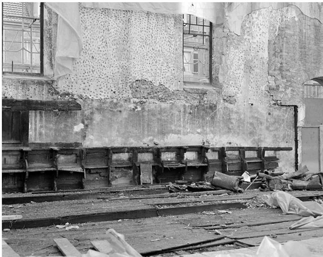
Stalles du mur sud de la nef après l'incendie de 1987.
