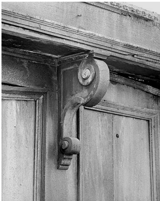
Détail d'une console soutenant le dais des dorsaux du mur sud du chœur, après l'incendie de 1987. 25, Montbéliard place Saint-Georges
