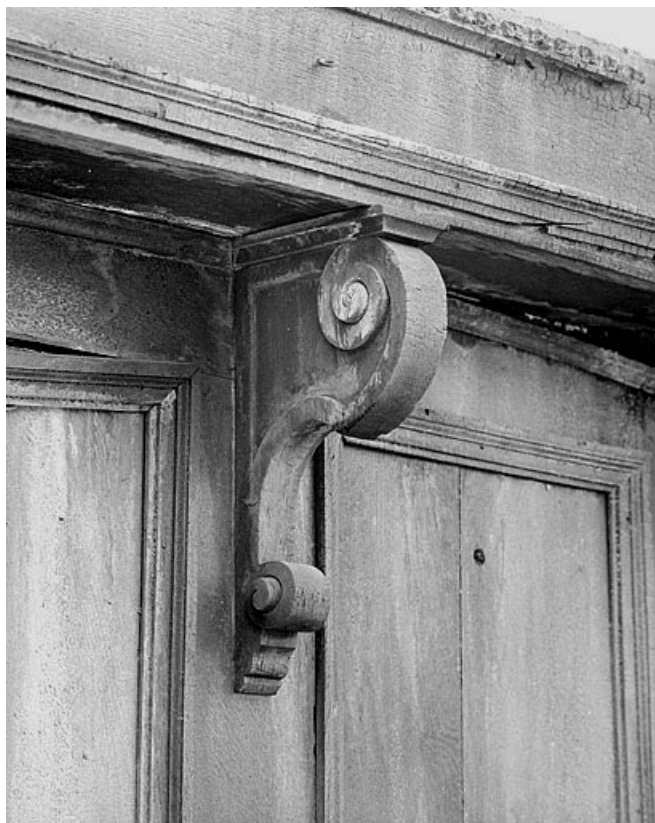
Détail d'une console soutenant le dais des dorsaux du mur sud du chœur, après l'incendie de 1987. 25, Montbéliard place Saint-Georges
