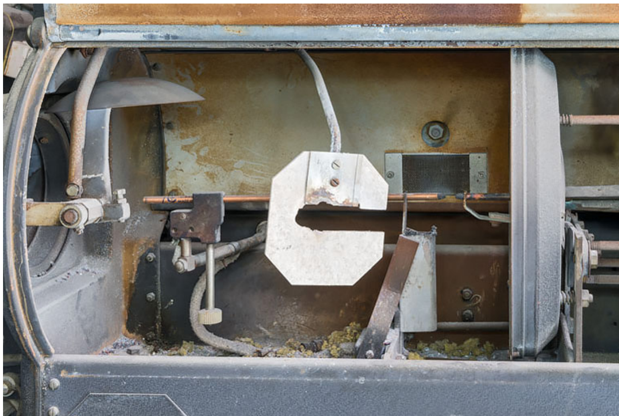
Projecteur côté jardin, lanterne : lampe à arc, en position de fonctionnement. 21, Beaune, 64 rue de Lorraine
