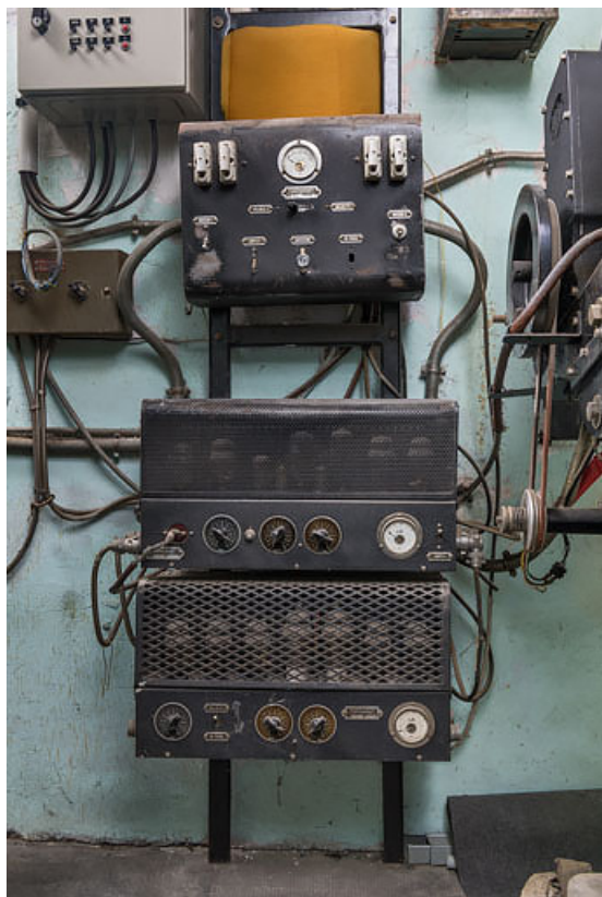
Installation de sonorisation : amplificateurs.
