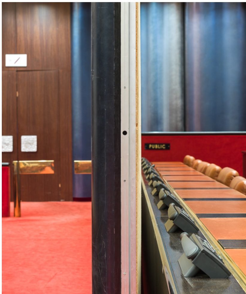
Salle des Assemblées : cloison coulissante de séparation, avec le système d'accroche des panneaux sur des planches de bois aggloméré.
