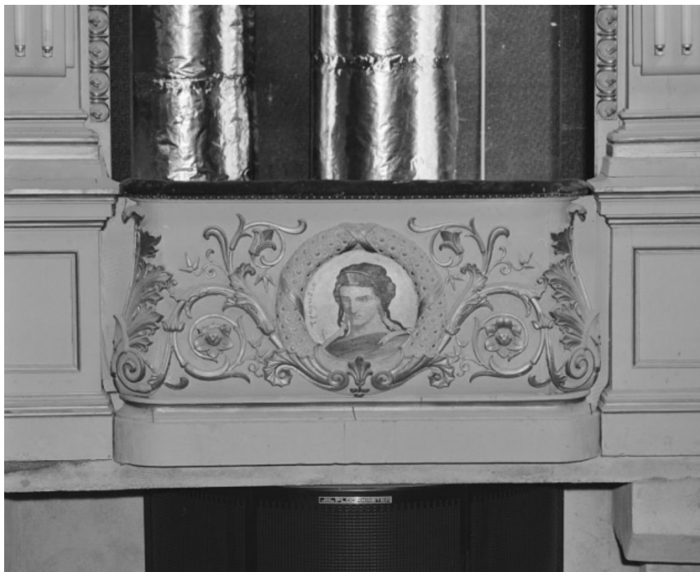
Loge d'avant-scène côté cour, 1er balcon, en 1988, avant restauration : décor du garde-corps avec la représentation de la Tragédie. 21, Beaune, 64 rue de Lorraine
