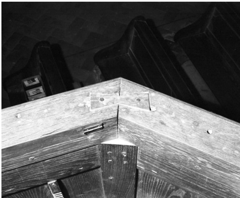
Détail de l'assemblage de l'appui rapporté de la cuve 21, Chivres Grande Rue
