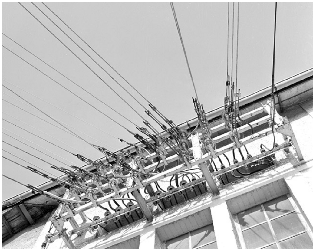
Détail du transformateur : départ de fils électriques (cadrage vertical). 90, Delle, 28 faubourg de Belfort
