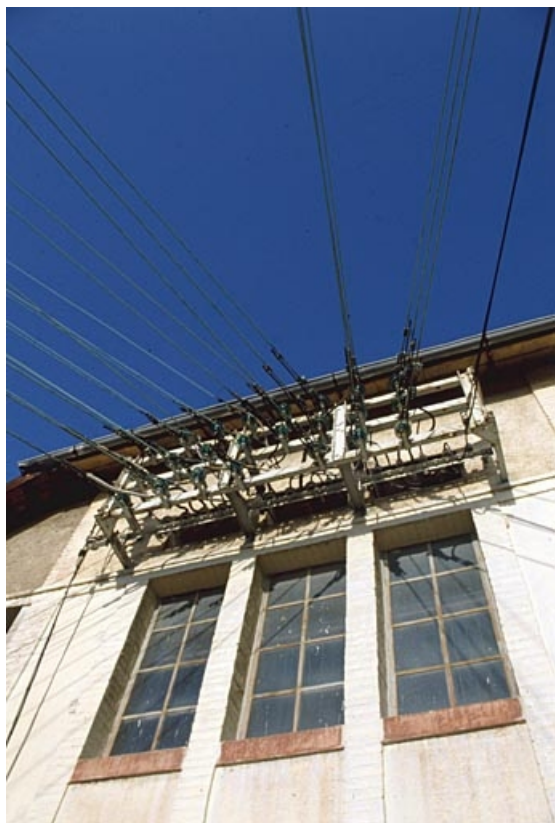
Détail du transformateur : départ de fils électriques.
