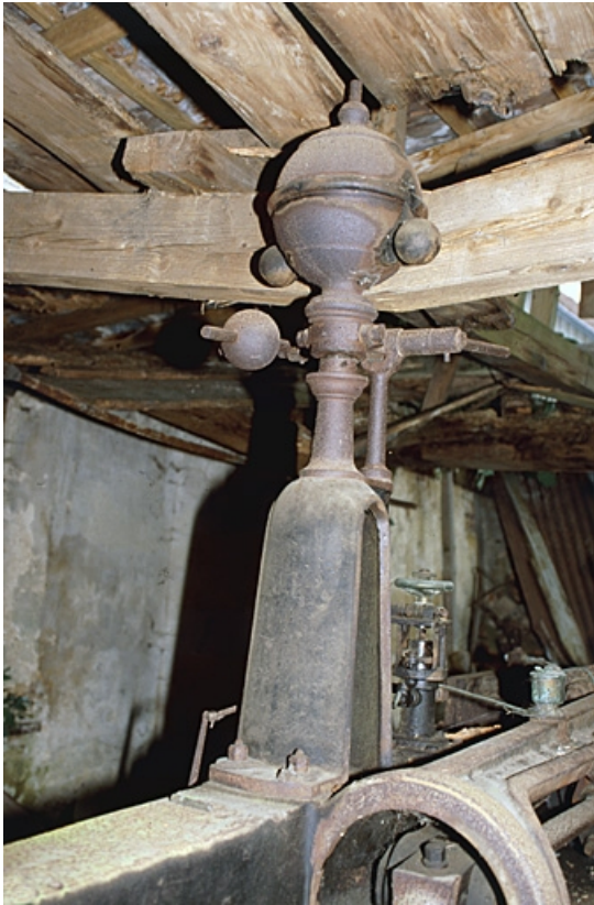
Machine à vapeur : détail du régulateur à boules. L'entrait de la charpente, brisé, repose sur le régulateur. 90, Suarce R.D. 13
