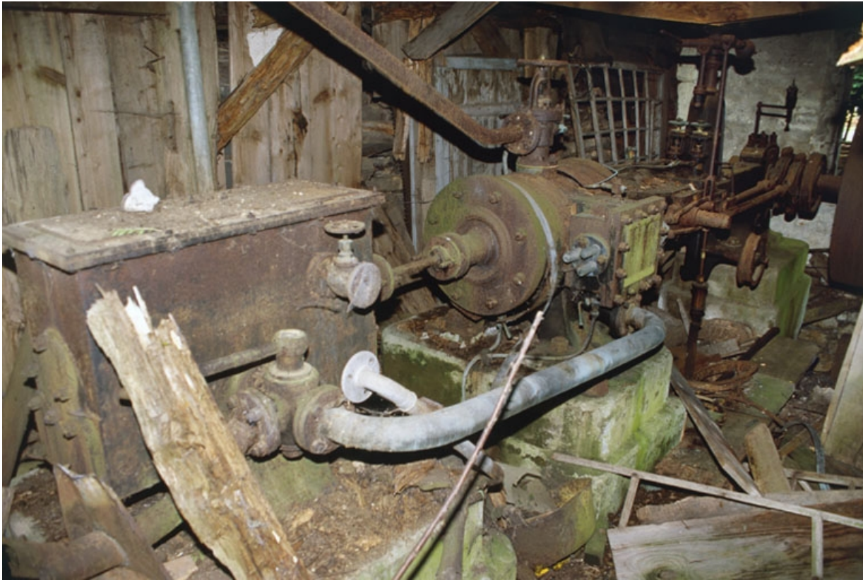
Vue d'ensemble de la machine à vapeur. 90, Suarce R.D. 13
