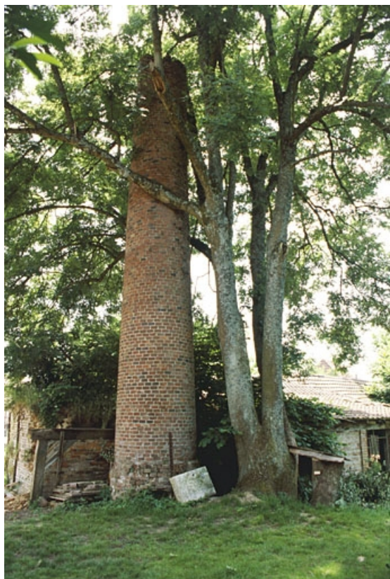
Cheminée et chaudière de la machine à vapeur depuis le nord. 90, Suarce R.D. 13
