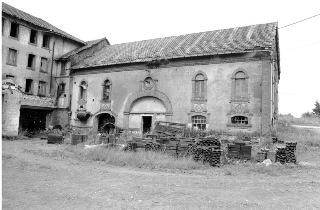
Briqueterie (?) en 1980. SRI. Enquête régionale sur les bâtiments industriels (1979-1981). 90, Froidefontaine, 2 à 7 rue André Viellard
