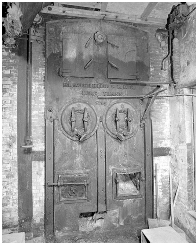
Chaudière de la machine à vapeur.
