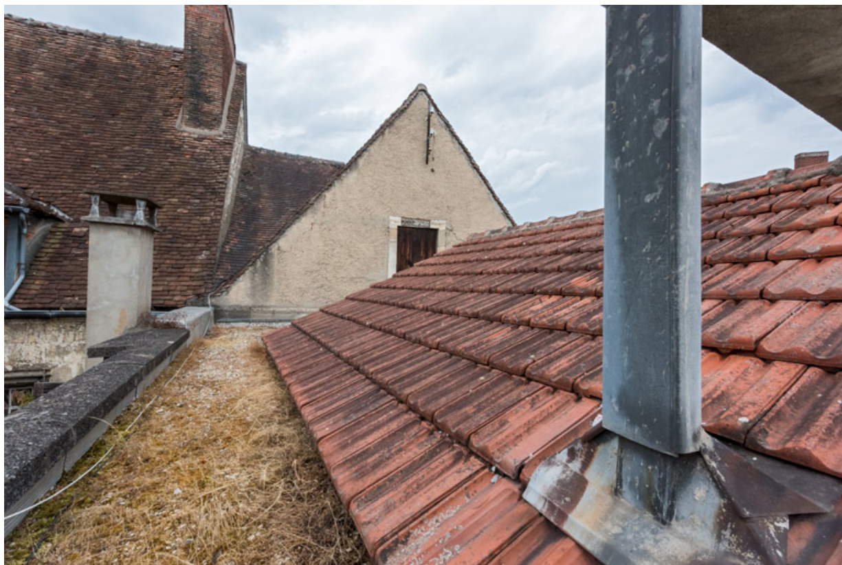
Terrasse sur la salle : lanterneau à droite et corps de bâtiment ancien au fond. 89, Auxerre, 65 rue de Paris
