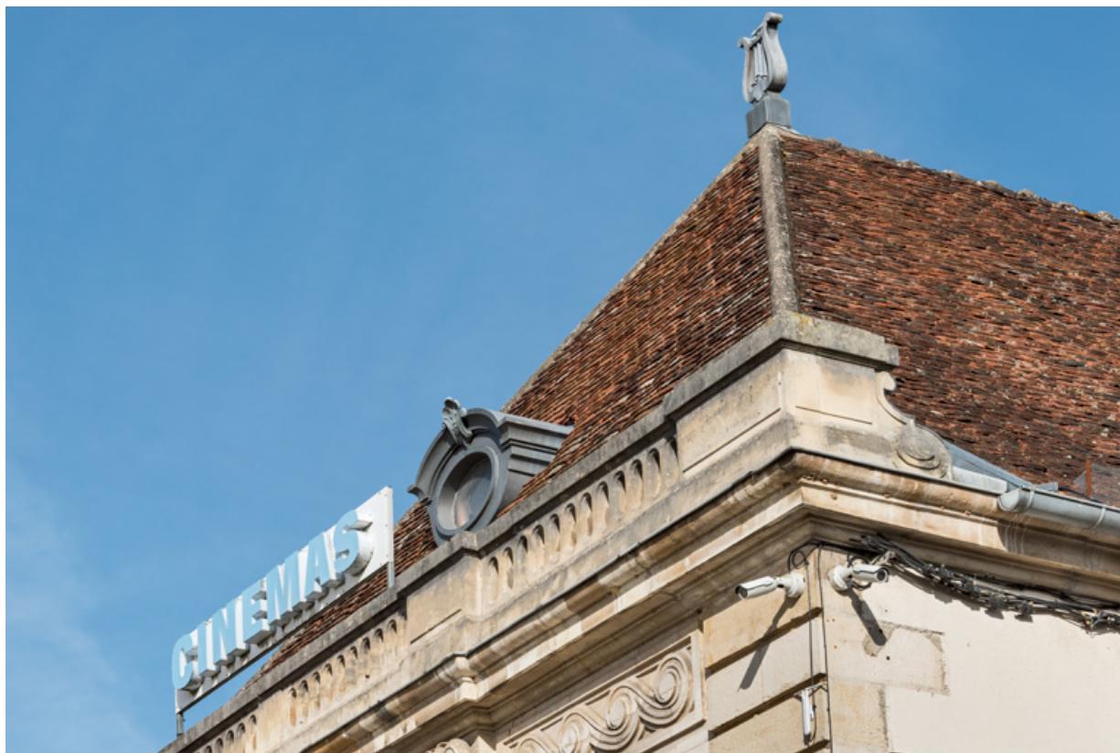
Façade antérieure : partie supérieure, vue de trois quarts, avec enseigne et épi de faitage en forme de lyre. 89, Avallon, 1 rue du Maréchal Foch
