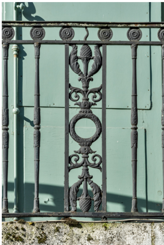
Façade antérieure, avant-corps central : détail du garde-corps en fonte du balcon. 89, Villeneuve-sur-Yonne, 25 rue Carnot
