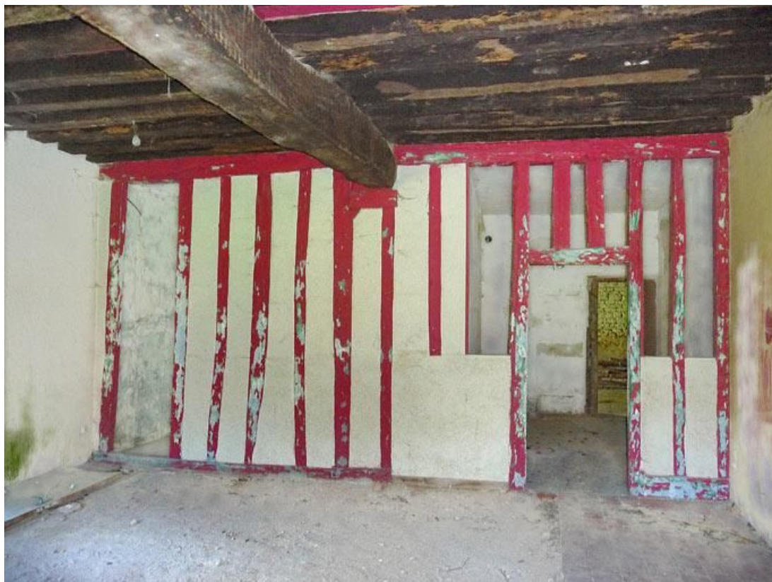
Première pièce du logis du rez-de-chaussée de la grange, cloison en pans de bois.
