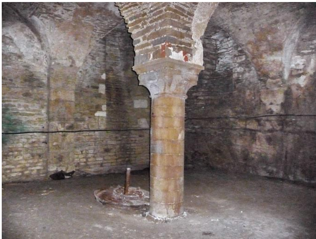
Cave sous la grange, supports des voûtes : pilastre, colonne et culot. 89, Vézelay Fontenay-près-Vézelay à Vézelay, lieudit : la Maladrerie
