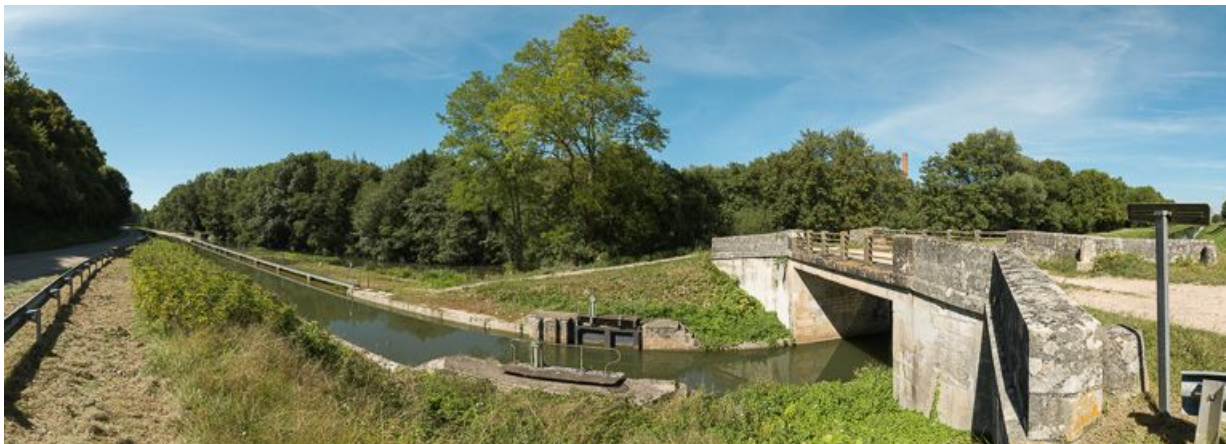
Vue d'ensemble de l'écluse de garde. On aperçoit la cheminée de l'ancienne usine (IA89002010). 89, Lucy-sur-Yonne, lieudit : bief 54 du versant Seine
