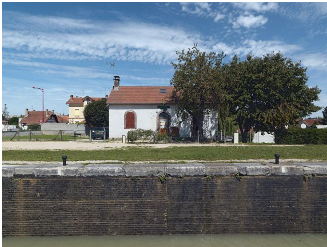
Maison éclusière et sas vus de face. Remarquez le sas en brique.
