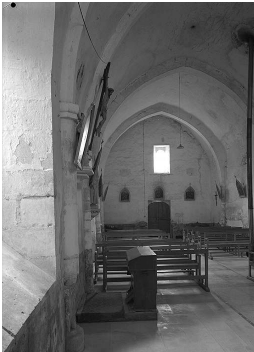
Vue est-ouest de la nef, avec voûte en berceau brisé et doubleaux.
