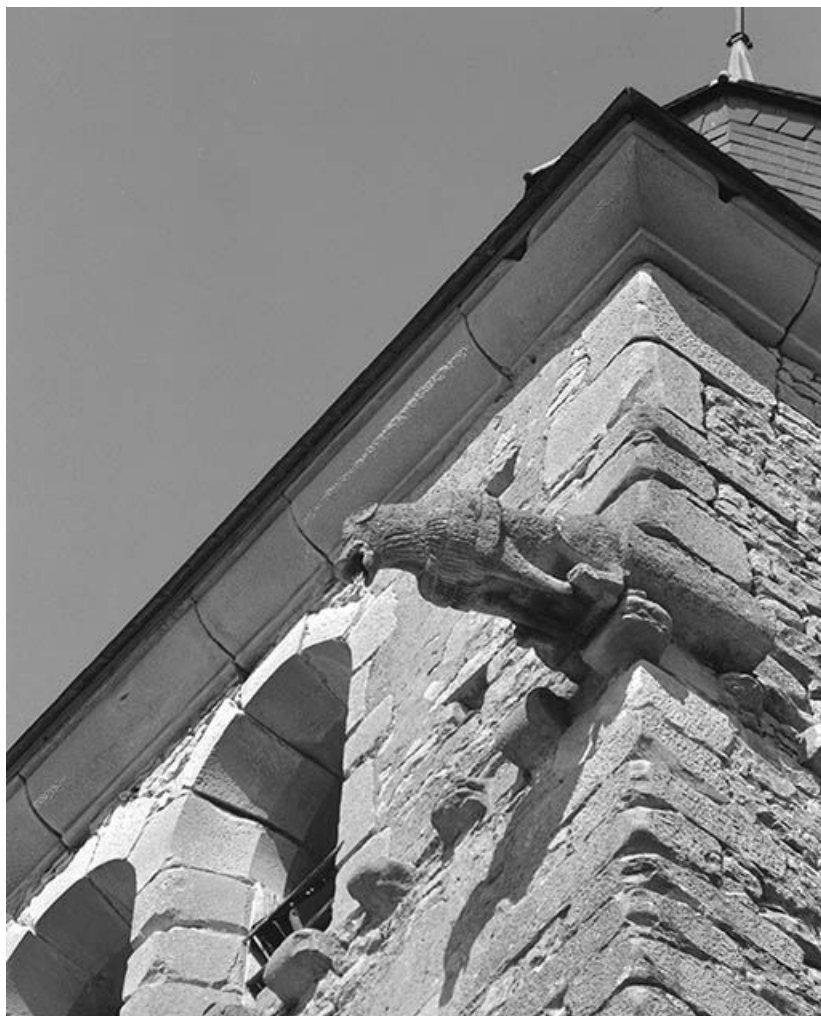
Façade droite du choeur, détail : gargoille gauche.
