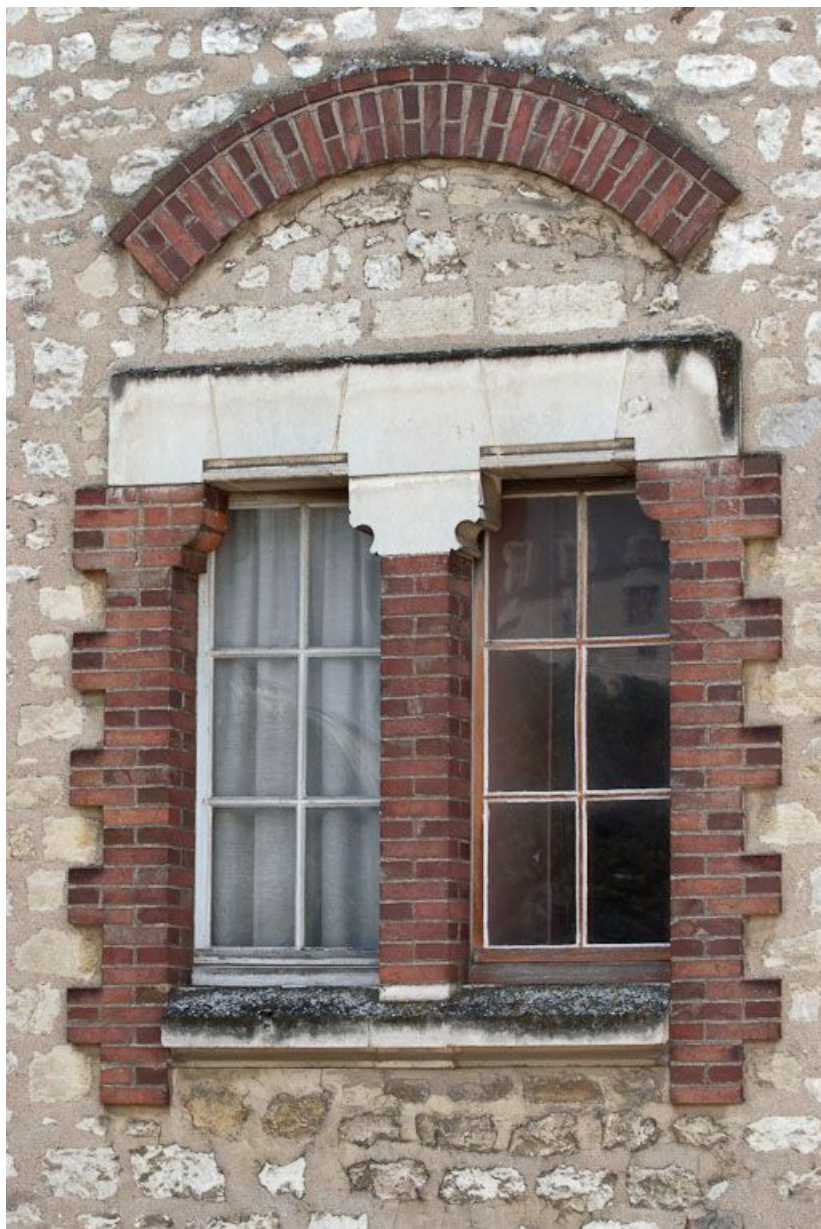
Petite construction, vestige du premier hôpital : fenêtres remaniées. 89, Joigny quai de l'Hôpital
