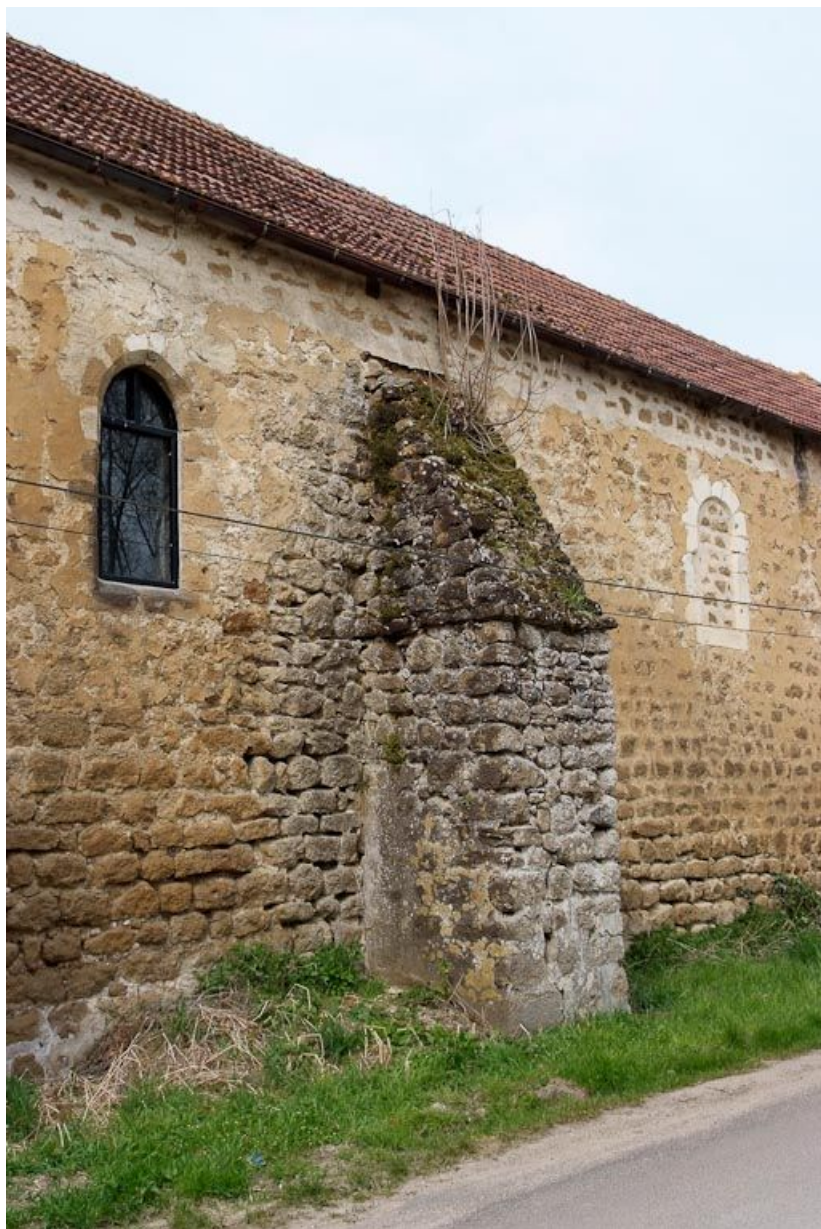
Chapelle : deuxième contrefort entre deux fenêtres du mur de long-pan sur rue. 89, Saint-Florentin, lieudit : la Maladrerie
