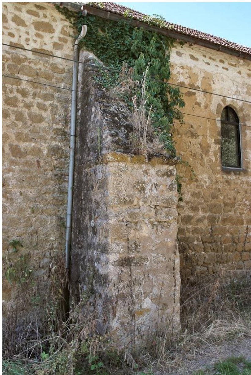
Chapelle : premier contrefort gauche du mur de long-pan sur rue. 89, Saint-Florentin, lieudit : la Maladrerie
