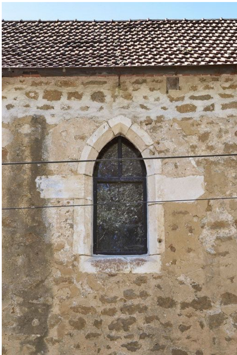
Chapelle : fenêtre brisée du mur de long-pan sur rue. 89, Saint-Florentin, lieudit : la Maladrerie
