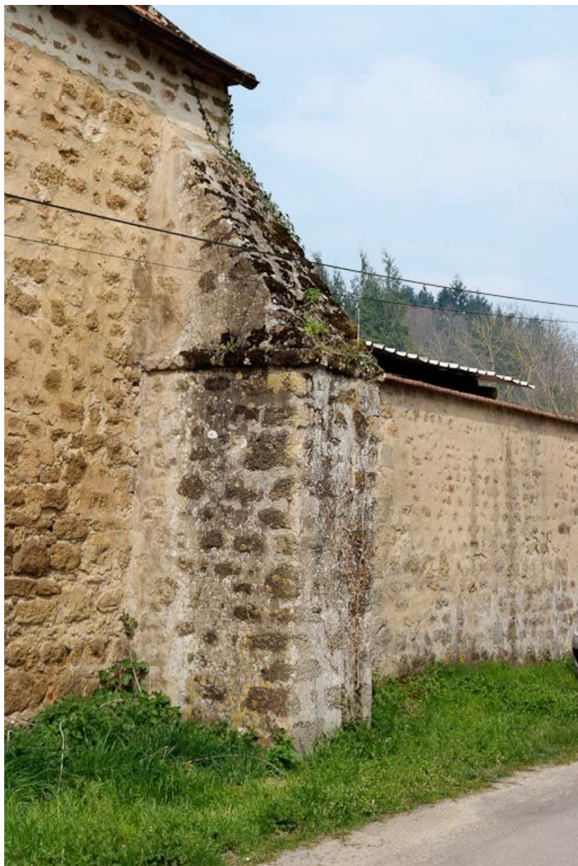
Chapelle : troisième contrefort du mur de long-pan sur rue. 89, Saint-Florentin, lieudit : la Maladrerie
