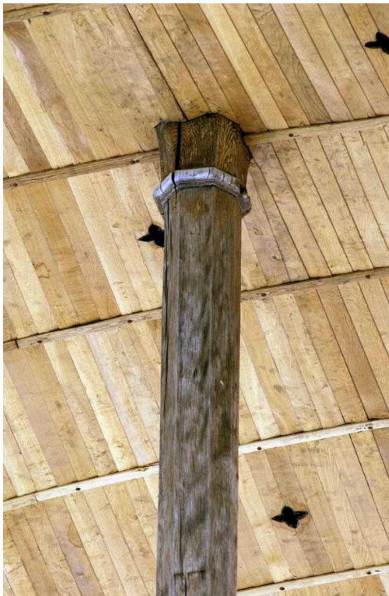
Ancienne salle des malades : départ du poinçon de la charpente. 89, Tonnerre Hôpital
