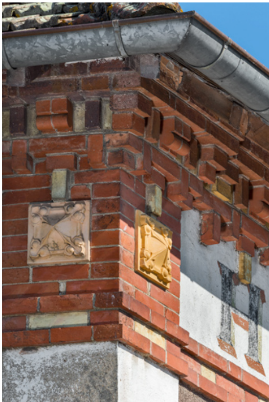
Hôtel-restaurant : décor en partie supérieure des façades postérieure et latérale droite. 71, Simandre, 87 rue du 19 Mars 1962
