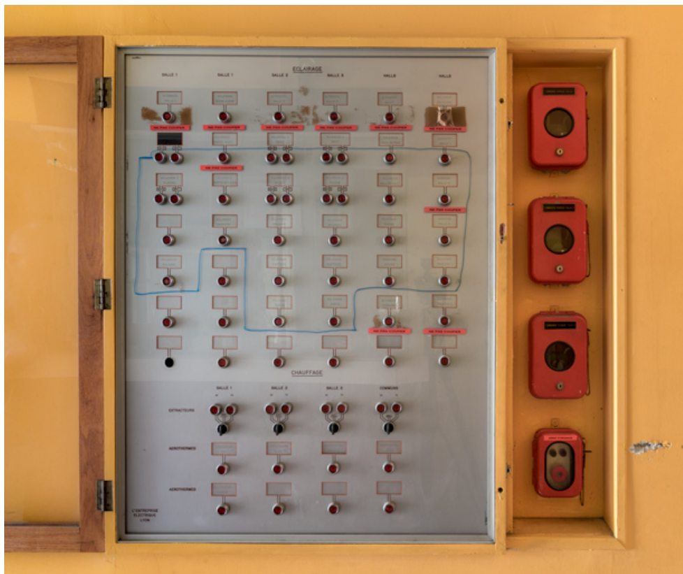
Cinéma : tableau de commande électrique dans le vestibule.
