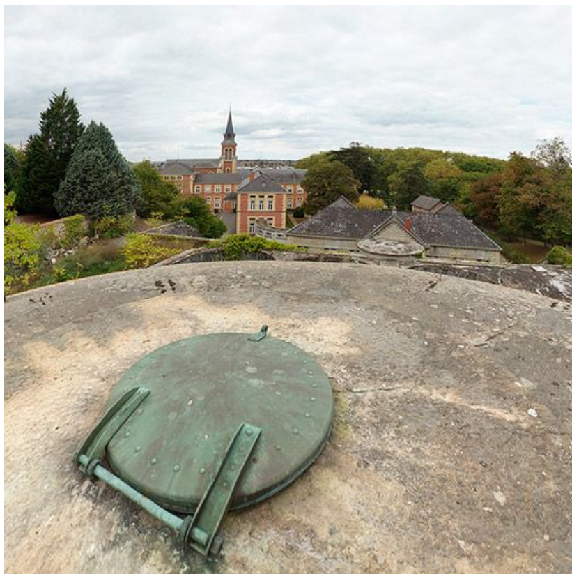
Vue d'ensemble de l'hôpital avec le trou d'homme du château d'eau au premier plan. 71, Bourbon-Lancy rue de la Chaumière
