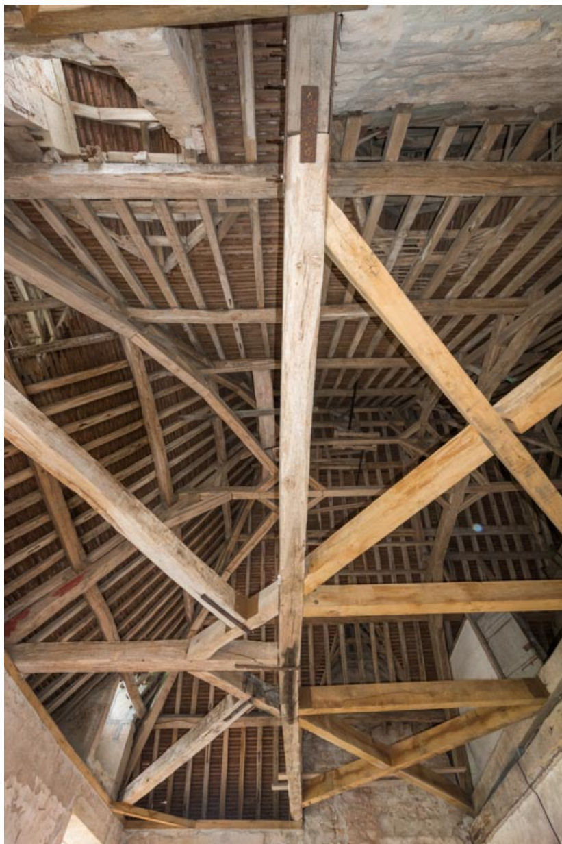
Charpente à chevrons portant-fermes, croupe sud-ouest, vue depuis le premier étage. 71, Saint-Bonnet-de-Joux chemin du Bois de Chaumont, lieudit : Château de Chaumont
