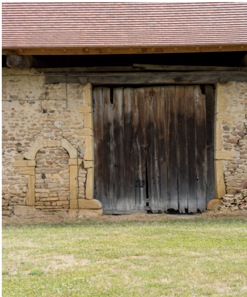
Détail de la façade antérieure de la grange : porte charretière de la remise, au centre de la façade, et ancienne porte piétonnière bouchée
