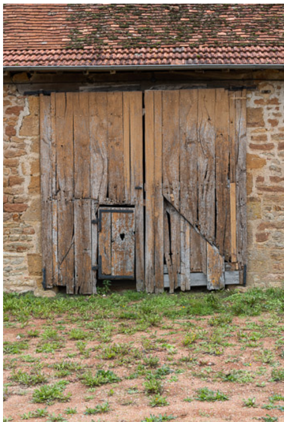
Ouverture principale de la grange : porte de la remise, où était placé le char à foin 71, Briant, lieudit : Farges
