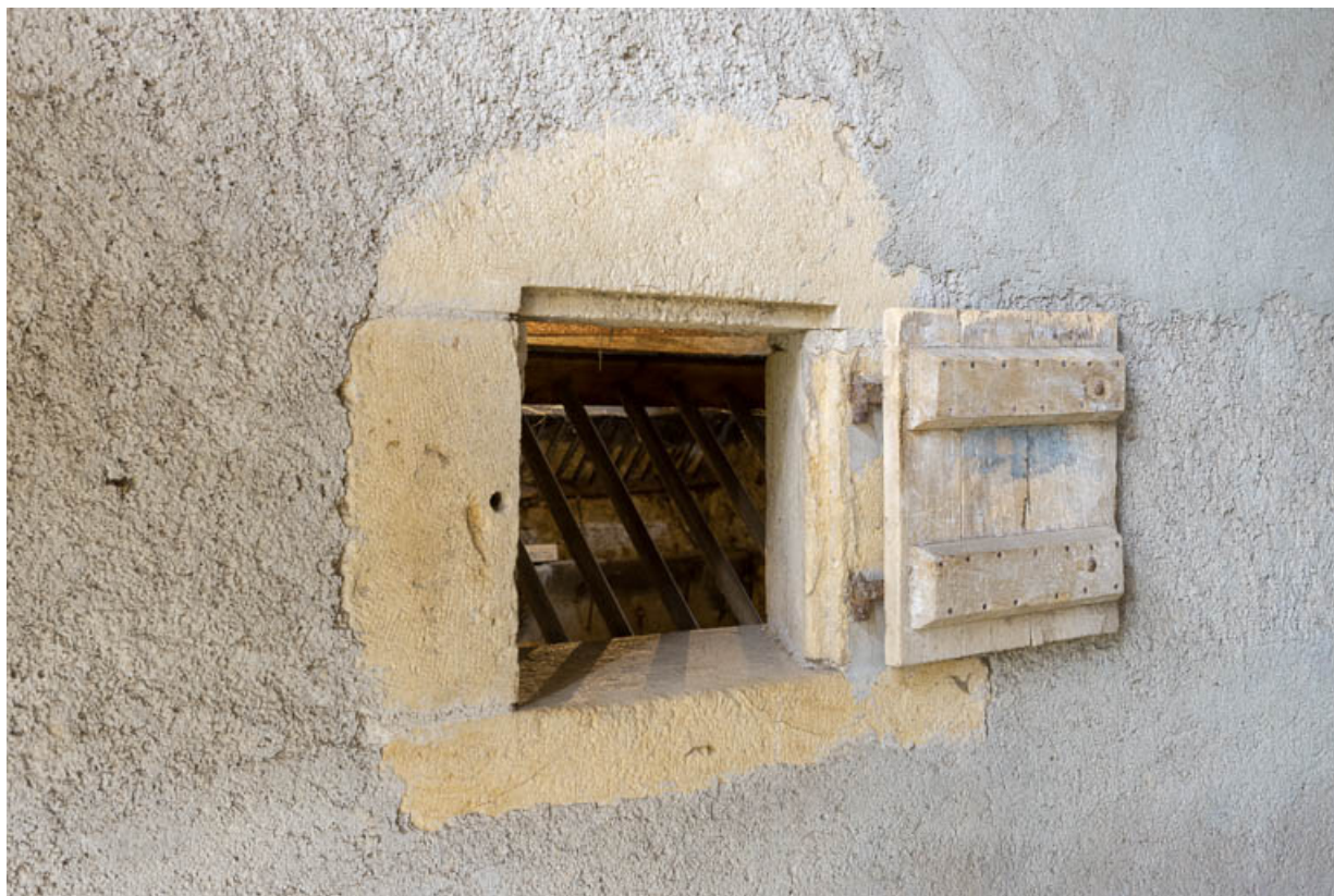
Feuron permettant de disposer le foin dans les rateliers depuis l'espace de la remise, où est placé le char. 71, Briant, lieudit : Farges
