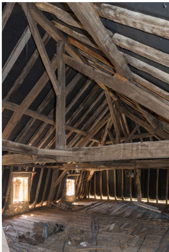
Vue de la charpente de toit brisé de la demeure
