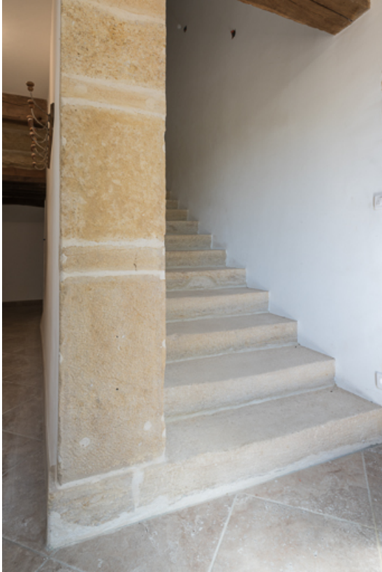
Vue de l'escalier rampe sur rampe de la demeure 71, Ligny-en-Brionnais, lieudit : les Sertines
