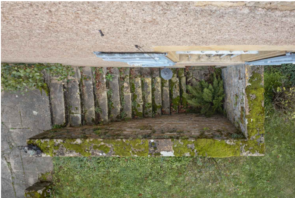
Vue en plongée sur la descente de la cave, sur la façade antérieure de la maison.
