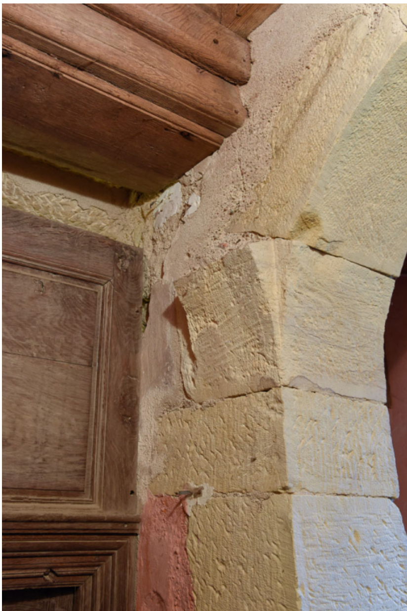
Pierre d'attente, vraisemblablement destinée à recevoir une arc à l'origine.
