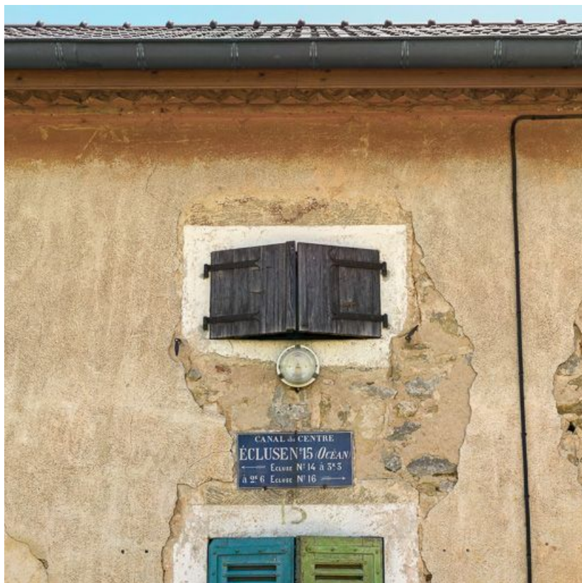
Détail de la plaque émaillée et de la frise en brique sous le toit.
