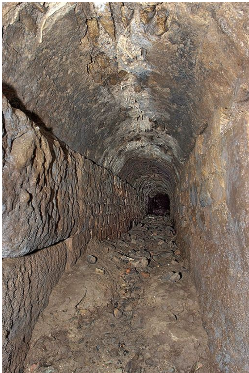
Première galerie : partie ouest partiellement obstruée par des gravats. 71, Bourbon-Lancy Parc Thermal
