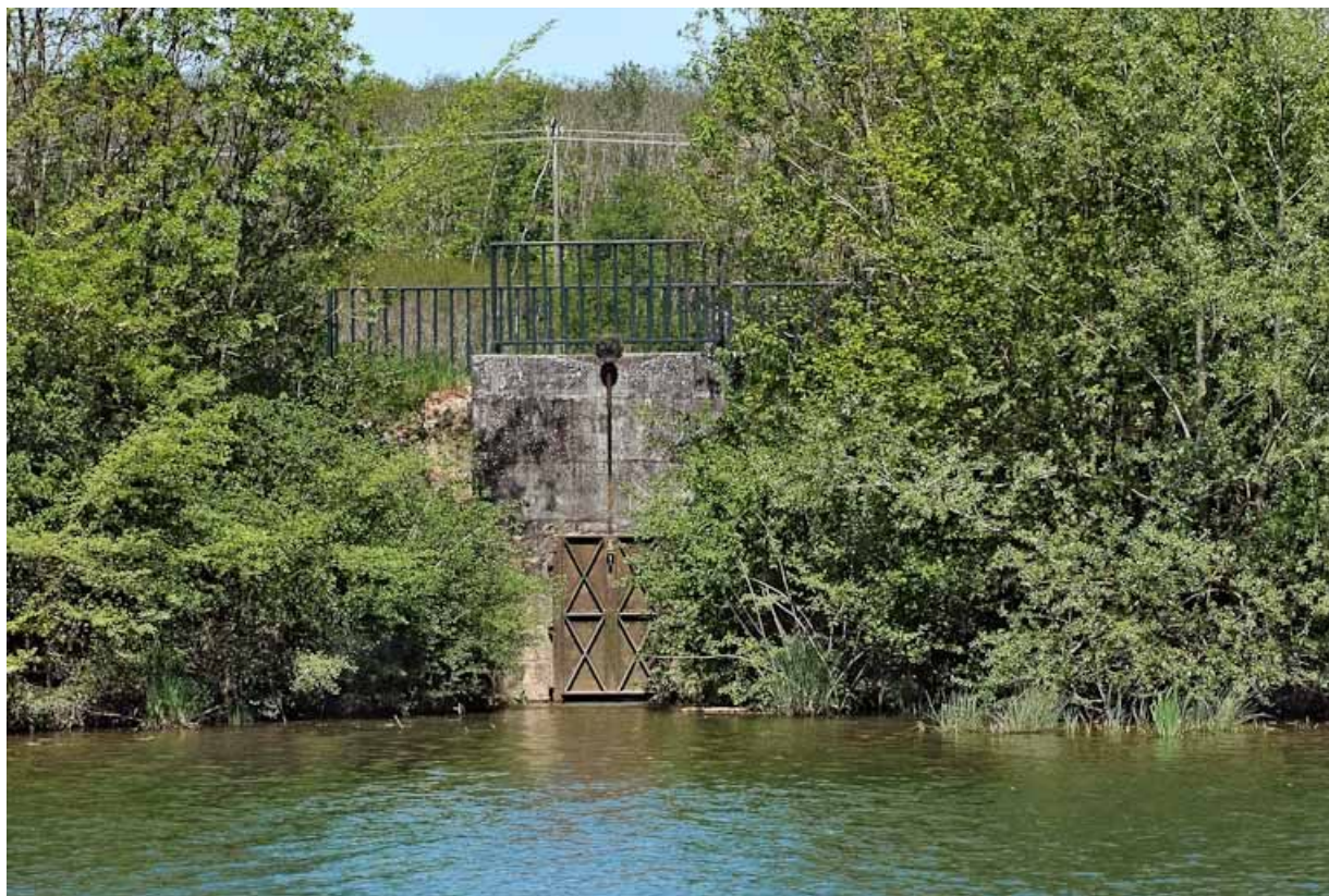
Vanne de l'aqueduc, Seille au premier plan.
