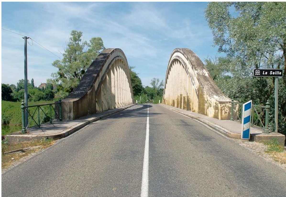
Pont de la Culée, il permet de traverser la Seille en direction de Branges. Vue rapprochée de la chaussée avec panneau "La Seille". 71, Branges, lieudit : La Culée
