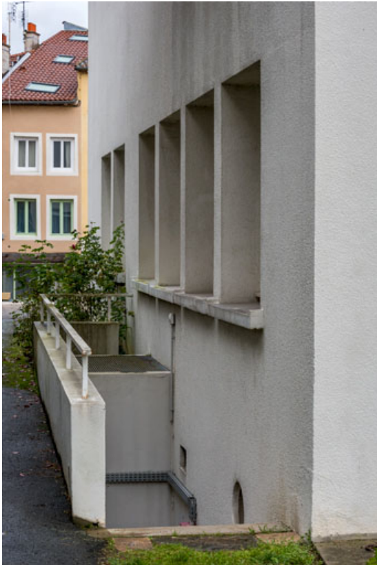
Vue partielle de la façade nord et de l'escalier desservant la chaufferie en sous-sol. 71, Mâcon, 32 rue Saint-Antoine
