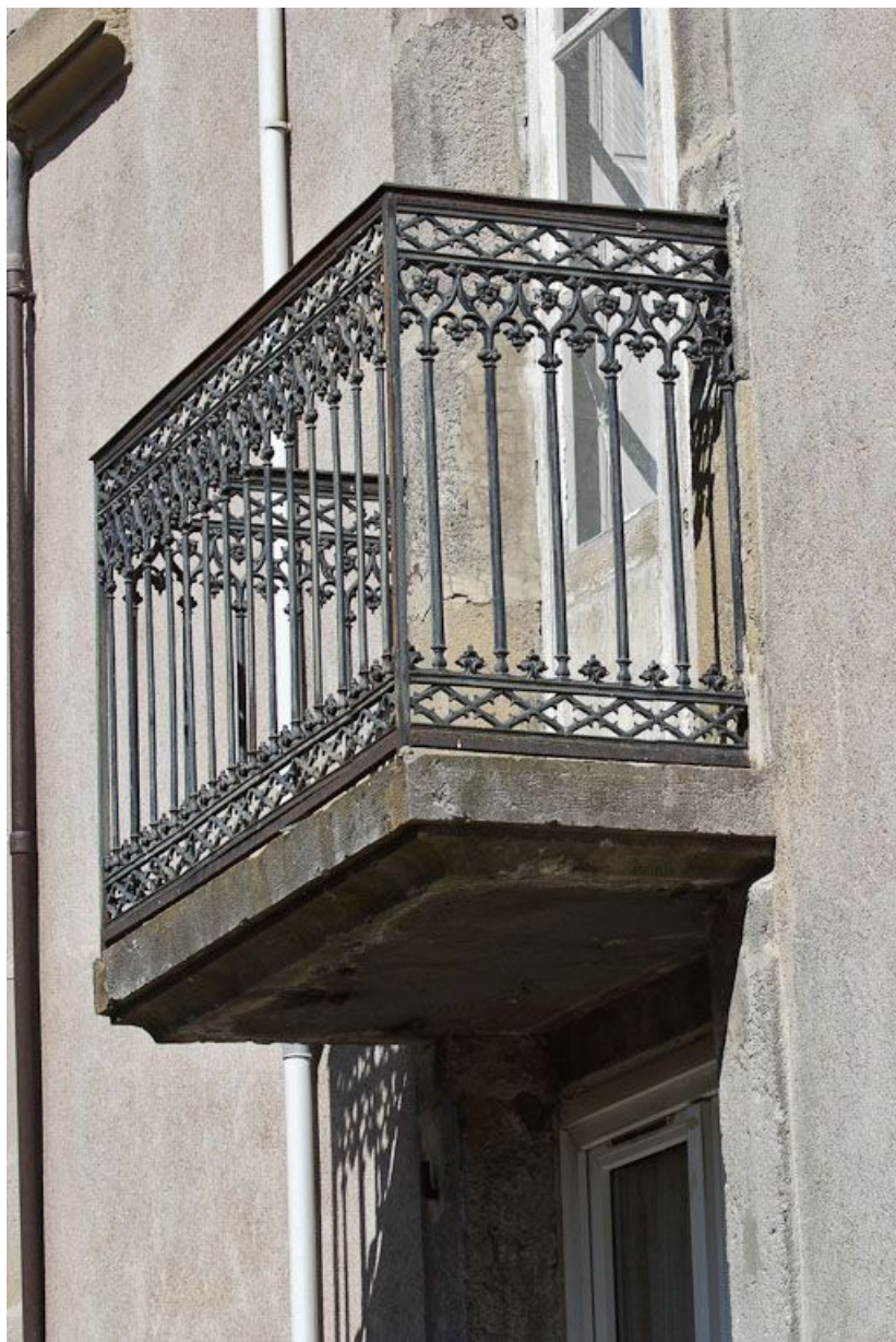
Pavillon postérieur de l'aile droite : détail d'un balcon ajouté postérieurement. 71, Autun, 9 boulevard Frédéric-Latouche
