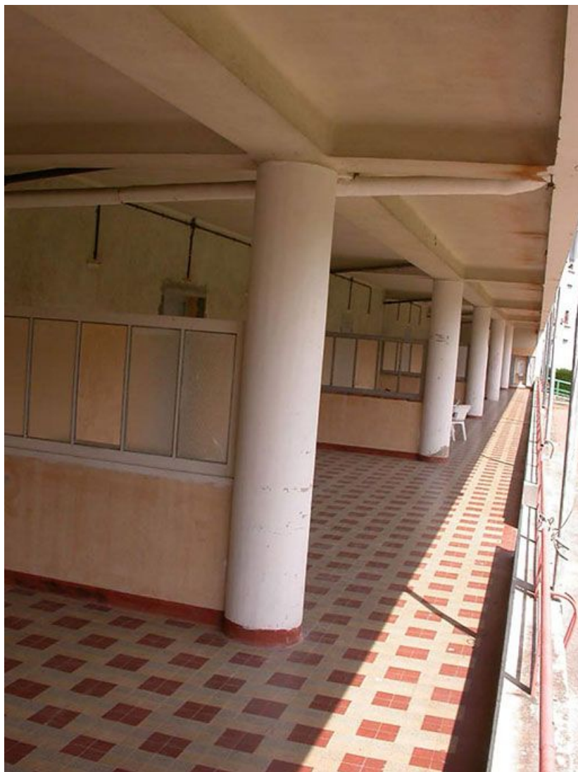
Galerie de cure sud, au rez-de-chaussée : détail des alcôves. 71, Bergesserin Bois de la Châtelaine, lieudit : bois de la Châtelaine
