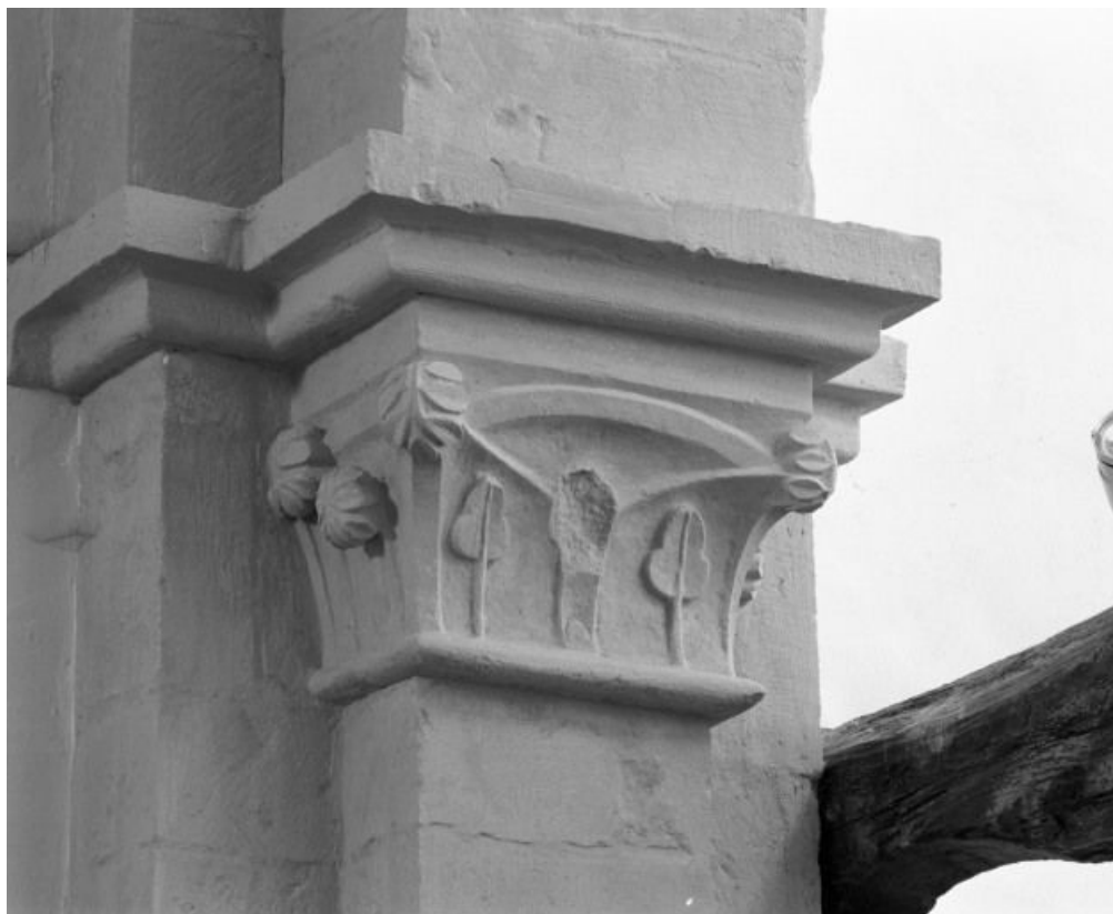
Avant-choeur sous clocher, arcade antérieure, chapiteau droit (n° 4 sur le plan de localisation). 71, Saint-Loup-Géanges Joseph Delissey, lieudit : Saint-Loup-de-la-Salle
