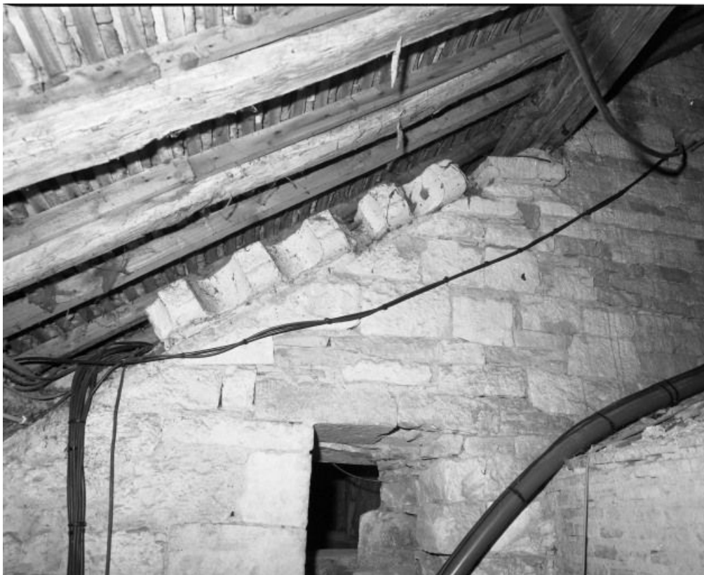
Partie supérieure du rampant du bas-côté droit, vue prise du comble de la sacristie.
