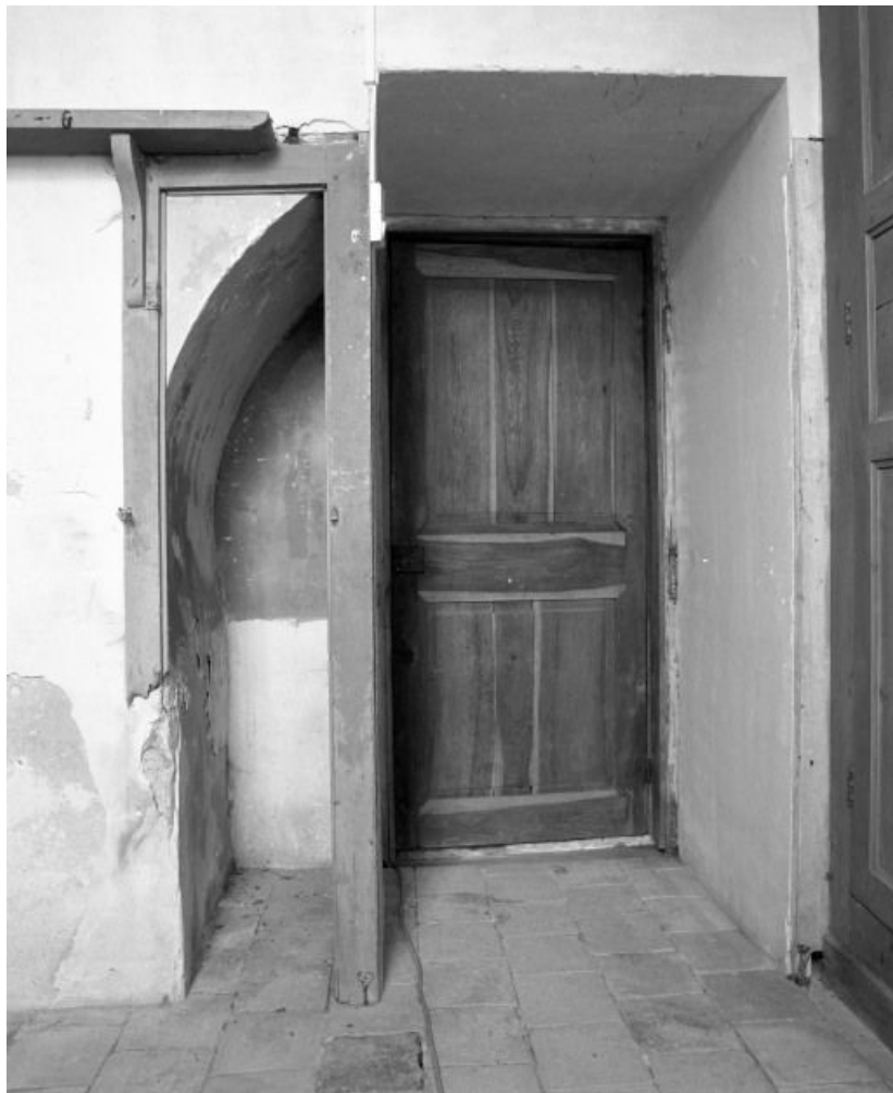
Sacristie gauche : vestiges de l'arcade qui ouvrait dans le Choeur. 71, Pontoux Eglise
