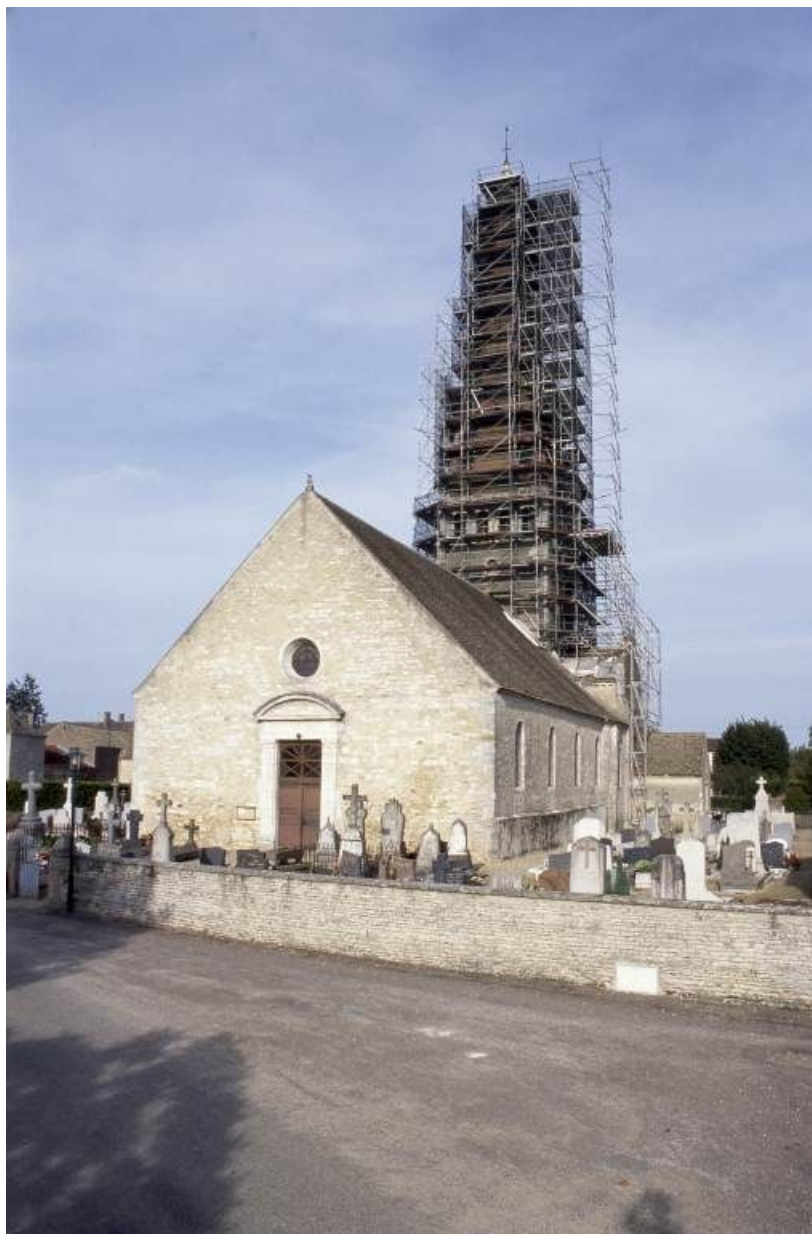
Vue prise du sud-ouest, pendant les travaux de réfection de la flèche. 71, Ciel C.D. 72
