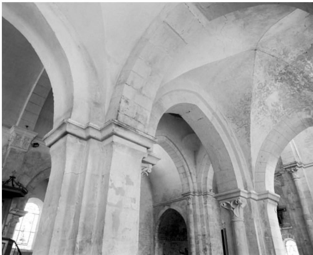
Bas-côté droit, 4e travée : angle nord-ouest, vestige d'un départ d'arc formeret. 71, Ciel C.D. 72
