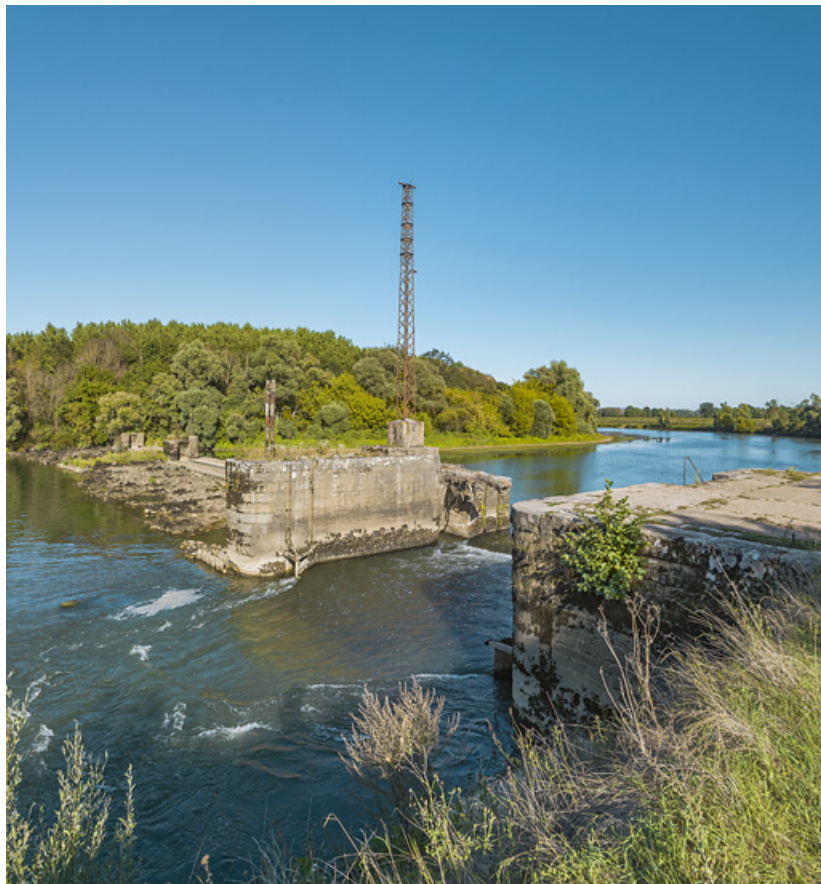
Vue d'ensemble du barrage en 2019 : au premier plan, l'ancien pertuis. 71, Charnay-lès-Chalon, lieu-dit : près du Pâquier du bief
