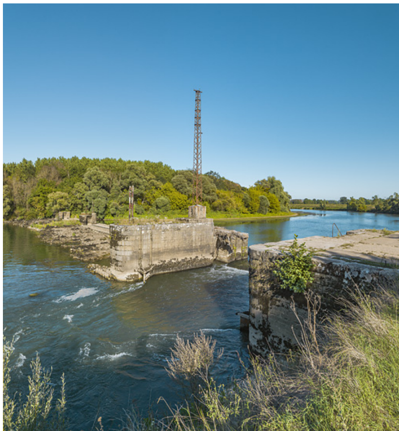
Vue d'ensemble du barrage en 2019 : au premier plan, l'ancien pertuis. 71, Charnay-lès-Chalon, lieu-dit : près du Pâquier du bief
