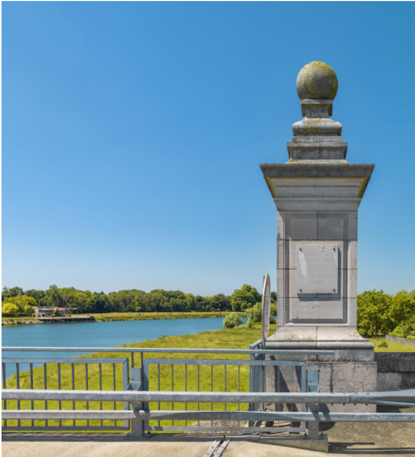
Détail d'une "borne" d'entrée du pont et de la plaque commémorative. 71, Verjux R.D. 139, lieudit : PK 159
