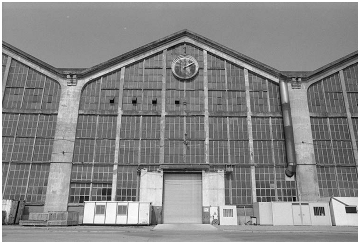
Façade antérieure de la travée centrale (C) de la fonderie de fonte.
