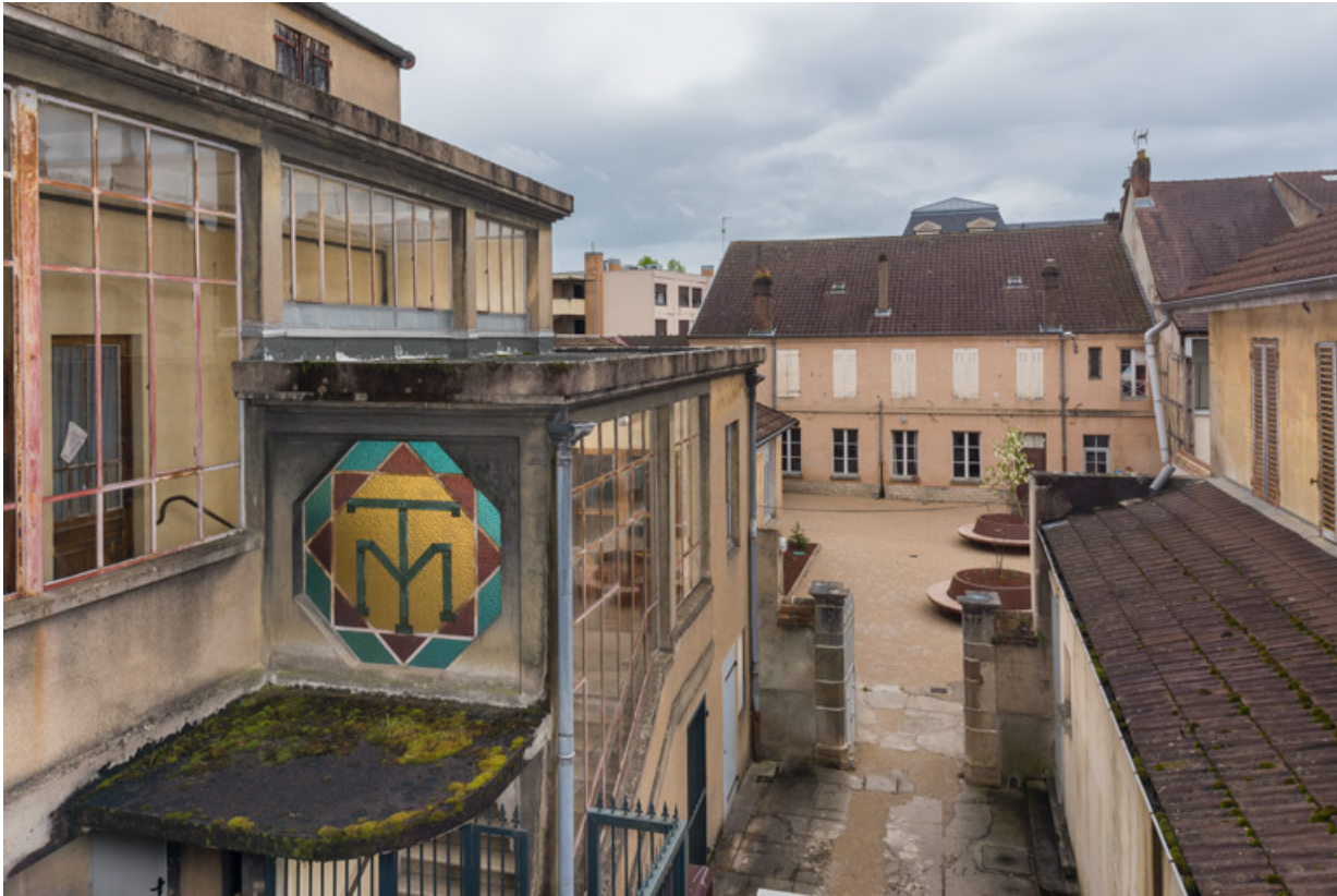
Cage de l'escalier principal (dépendance est) à gauche et loges d'acteur à droite, depuis la galerie vitrée. 71, Louhans Grande Rue 88
