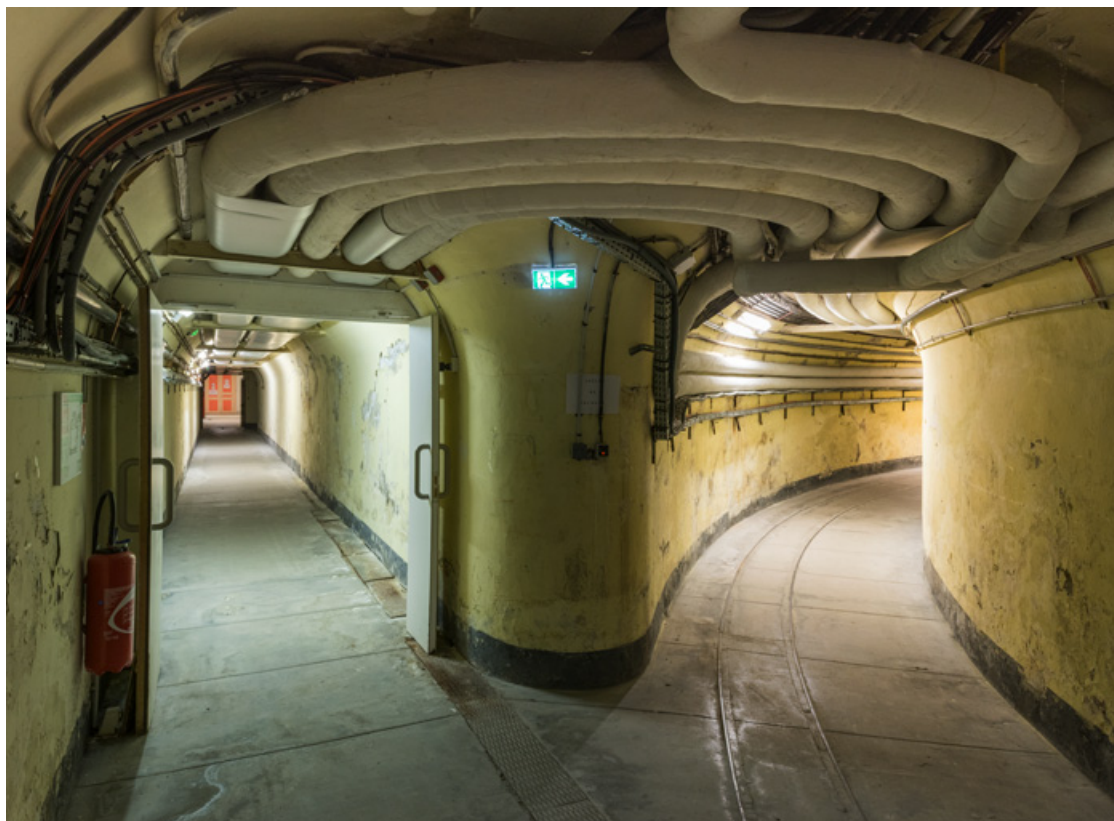
Sous-sol : couloir souterrain. A gauche dessert de la salle du jeu de paume (actuel Pavillon de l'Industrie), à droite de l'aile de la Marine.
