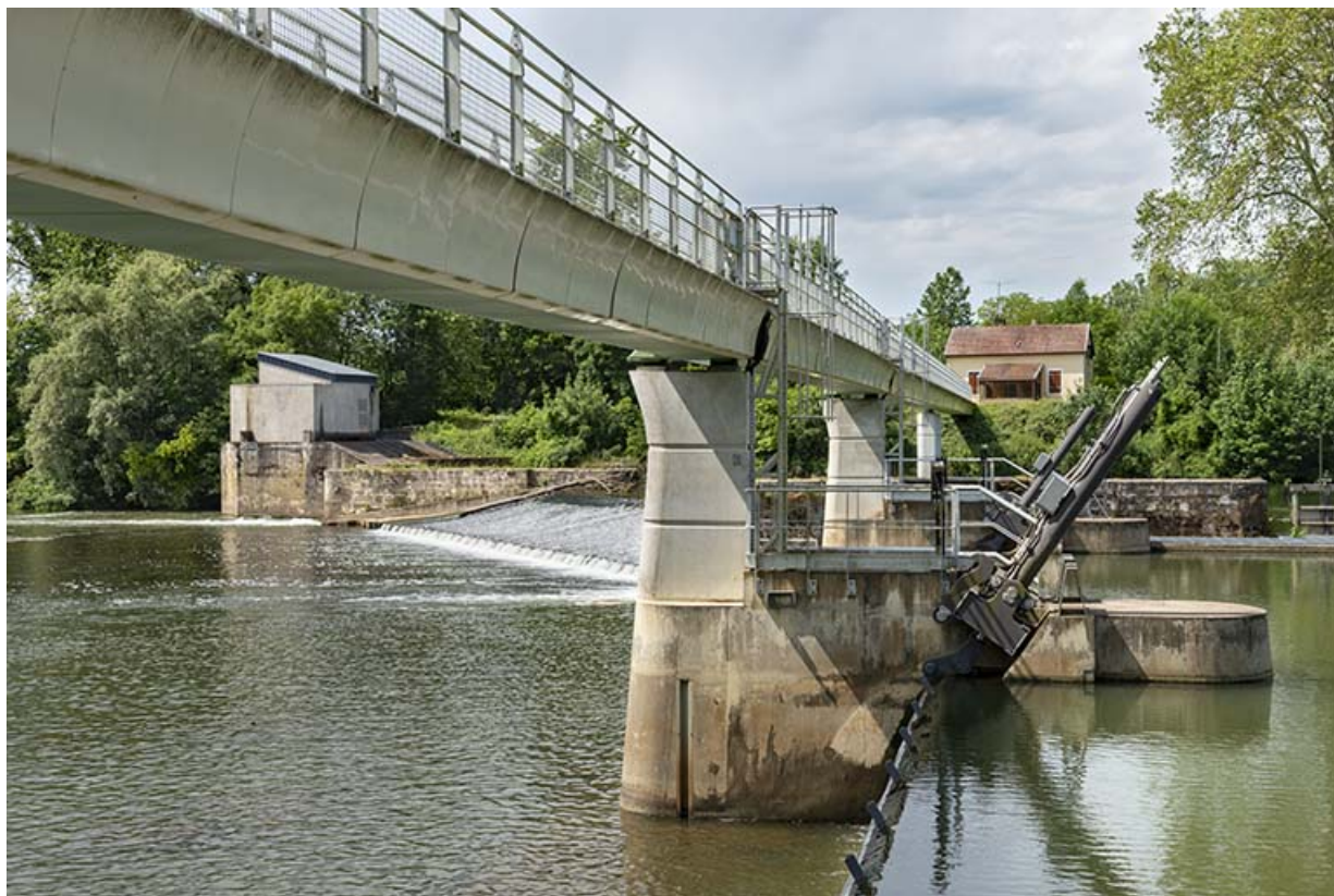
Vue de détail sur les clapets.
