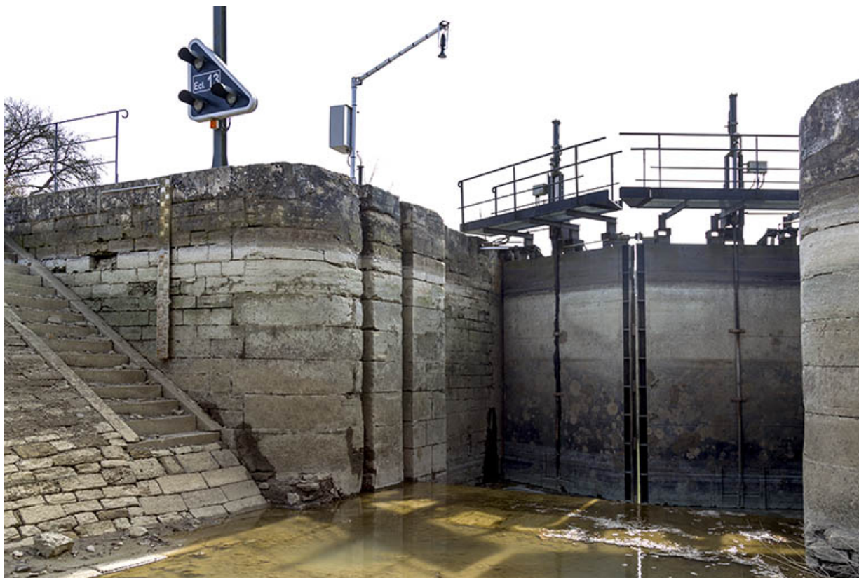
Vue sur la tête amont avec l'estacade de guidage et la porte munie de ses vantaux. 70, Savoyeux
