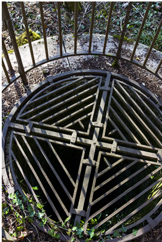
Grille de protection posée sur la margelle. 70, Savoyeux
