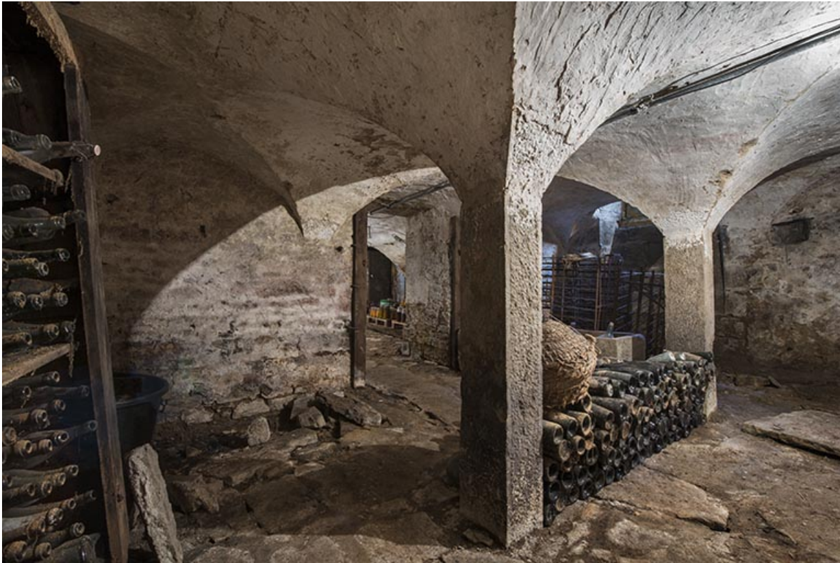
La cave, partie voûtée sur colonnes. 70, Purgerot rue de la Fontaine carrée
